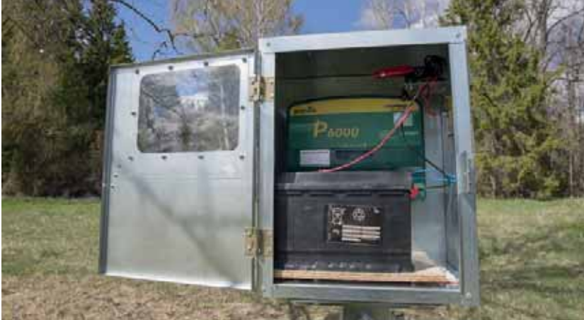
Bild 30. Plåtskåp för montering av batteriaggregat.
