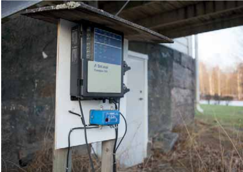
Bild 89. Elaggregat och åskskydd.
