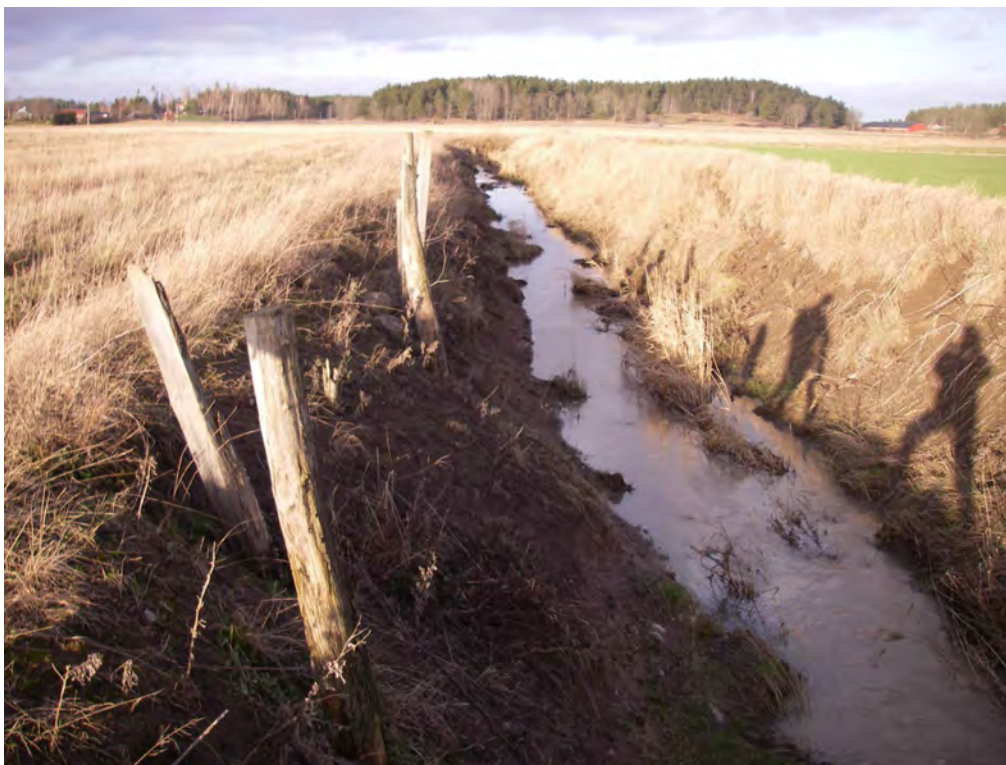
Bild 10. Branta dikesslänter i kombination med erosion har lett till att stora mängder jord rasat ner i diket. På bilden syns också resterna av de pålar som slagits ner i tidigare försök att hindra jordmassorna från att rasa. Foto: Anuschka Heeb
