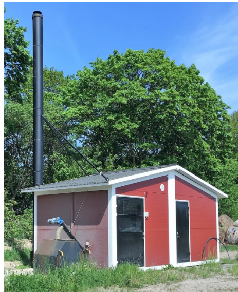
Värmecentral med fliseldning
